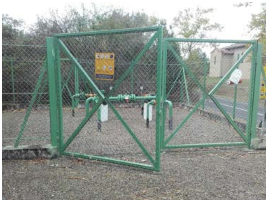
Photographie 1 : Poste de sectionnement Montauban ZI Parages
